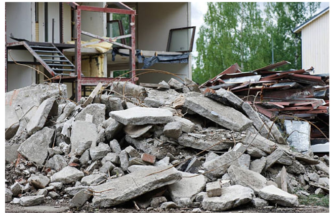
Illustration - Bâtiment conçu pour résister à un vent moyen, après sa rencontre avec un vent fort mais pas exceptionnel.
